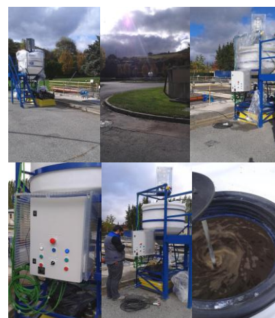
Imágenes del prototipo demostrativo instalado en la EDAR de SMSA
